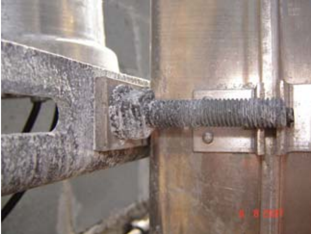
Parafuso não protegido com CorrosionX
